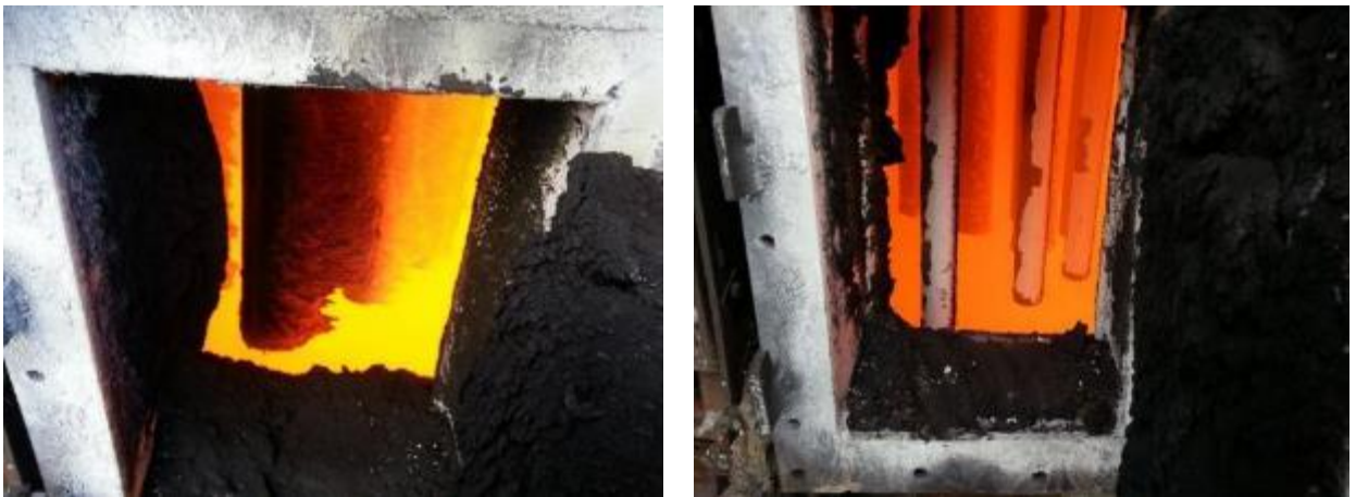
Рисунок 3.11 – Отложения пыли на испарительной части термосифона (вид через лаз): до и после очистки
